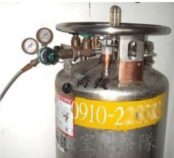
▲這種液態氮應該已經很接近儲槽等級了，排氣閥應該要用管子將排出氣體排於室外。
