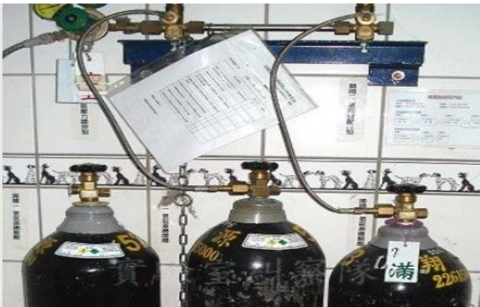
▲鋼瓶每次裝卸應該要用皂泡來檢測是否漏氣，檢查表應該放在鋼瓶旁，可作為查驗或提醒之用
